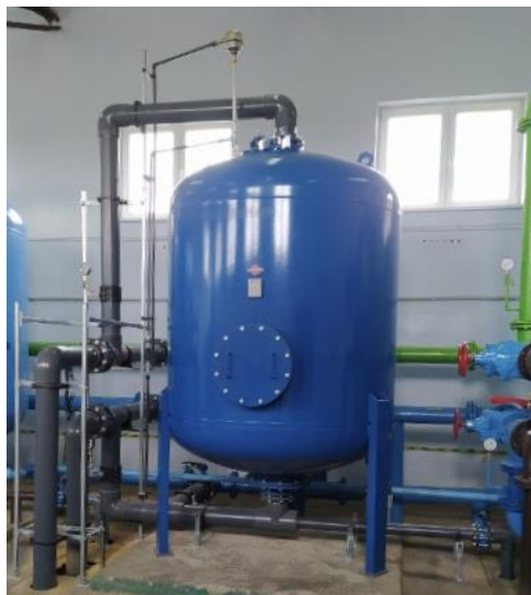
Filtr pionowy na obiekcie Stacji Uzdatniania Wody w Czerlejnku
