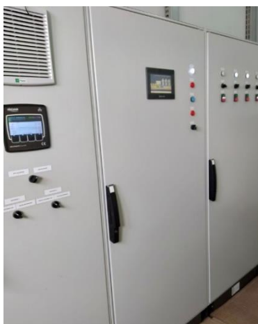
Układ zasilająco-sterujący na obiekcie Stacji Uzdatniania Wody w Czerlejnku
